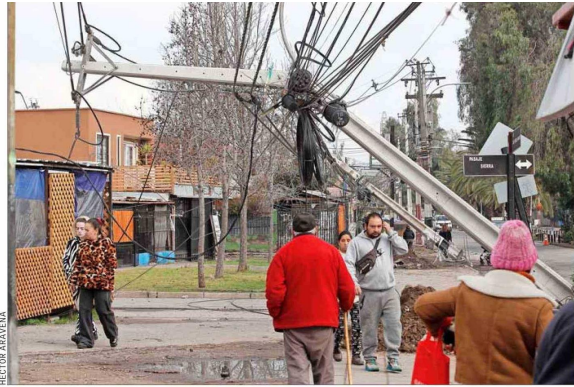
POSTES. Las fuertes ráfagas de viento hicieron que cientos de postes eléctricos de baja y mediana tensión se cayeran, dejando sin luz a miles de clientes.
