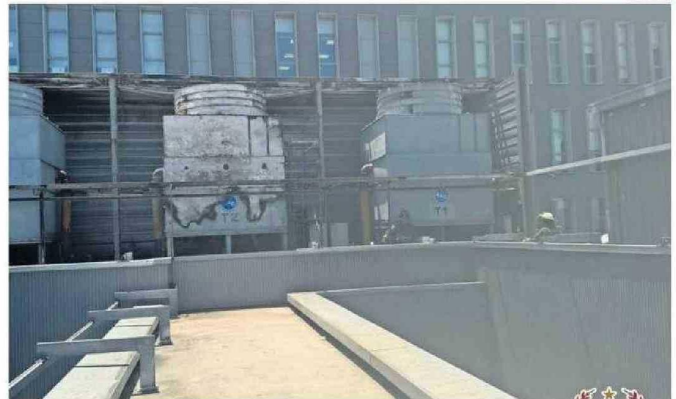
ASÍ QUEDÓ EL LUGAR DONDE FUE EL INCENDIO Y SE INVESTIGA EL POR QUÉ OCURRIÓ.
