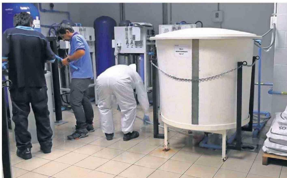
ESTE ES EL TERCER EPISODIO DE FILTRACIÓN DE AGUA EN EL HOSPITAL REGIONAL
