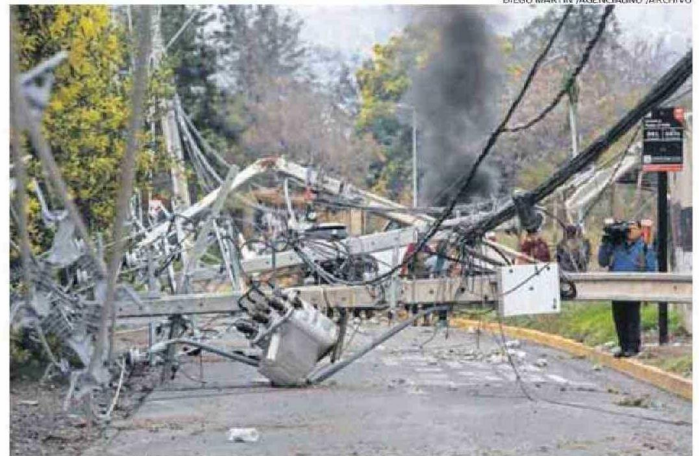
INFRAESTRUCTURA ELÉCTRICA FUE DAÑADA POR VIENTOS DE MÁS DE 120 KM/H EN LA CAPITAL, A INICIOS DE MES.
