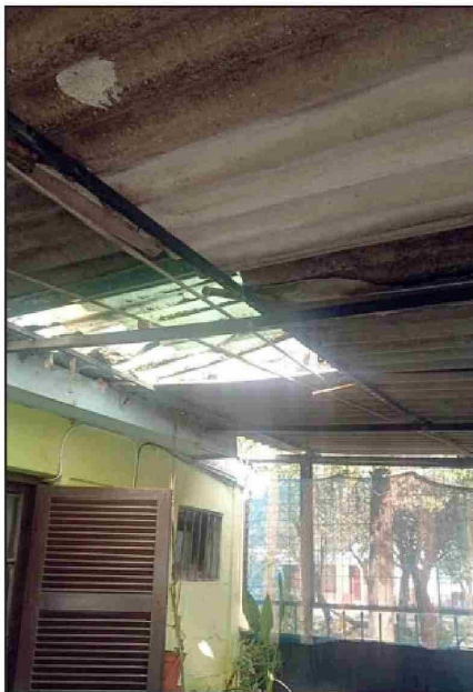
Otra imagen de daños en una casa
