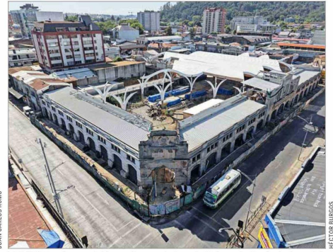
TEMUCO. — Luego del incendio que destruyó el Mercado Central, el municipio alista un ambicioso proyecto para su recuperación.
