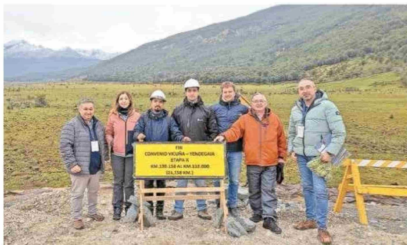
Hasta acá llega el camino en construcción en el extremo austral de la Tierra del Fuego chilena, en el Frente Norte que está uniendo Estancia Vicuña (Timaukel) con bahía Yendegaia (Provincia Antártica), al que seguirá el avance de su conexión con el Frente Sur entre los años 2030 y 2031.
