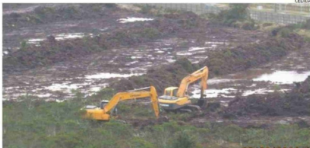
LAS OBRAS DE LAS INMOBILIARIAS QUE SE EJECUTABAN SOBRE EL HUMEDAL ESTÁN PARALIZADAS..
