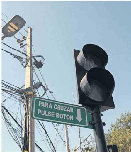
SEMAFOROS APAGADOS GENERARON PROBLEMAS EN EL TRÁNSITO.
