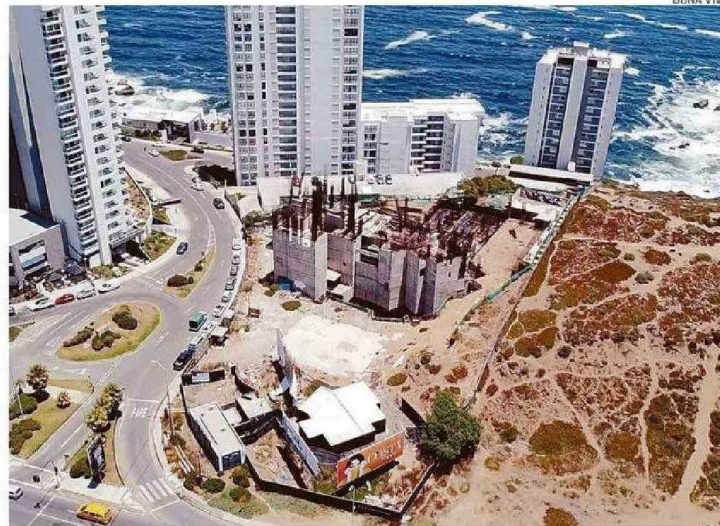
OBRAS EN ALTO SANTORINI SE ENCUENTRAN PARALIZADAS DESDE 2019, TRAS UN FALLO DE LA CORTE SUPREMA.
