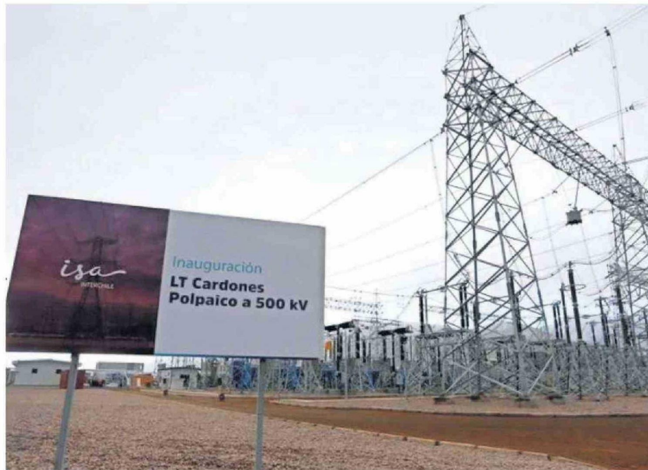
La falla ocurrió en uno de los sistemas de transmisión eléctrica del país, específicamente en la subestación Nueva Pan de Azúcar - Polpaico.
