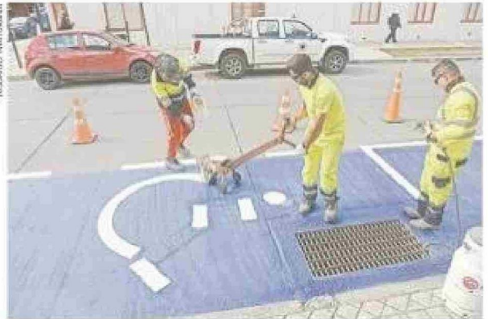
Este miércoles se ejecutaron obras de demarcación en calle Lautaro Navarro con Errázuriz.
