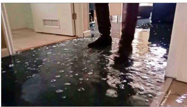
ANEGAMIENTO. —Hubo departamentos a los que ingresaron hasta 600 litros de agua, dañando alfombras, pisos y muebles.
