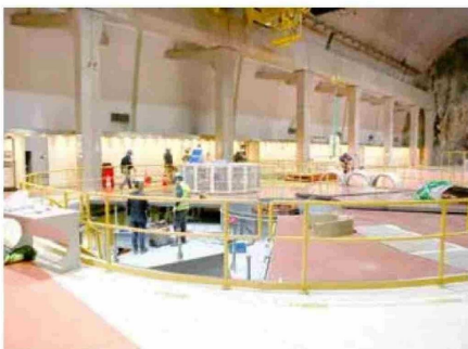
Una de las dos turbinas generadoras con que cuenta Central Colbún se encuentra en mantenimiento. Ubicada en la caverna de máquinas.
