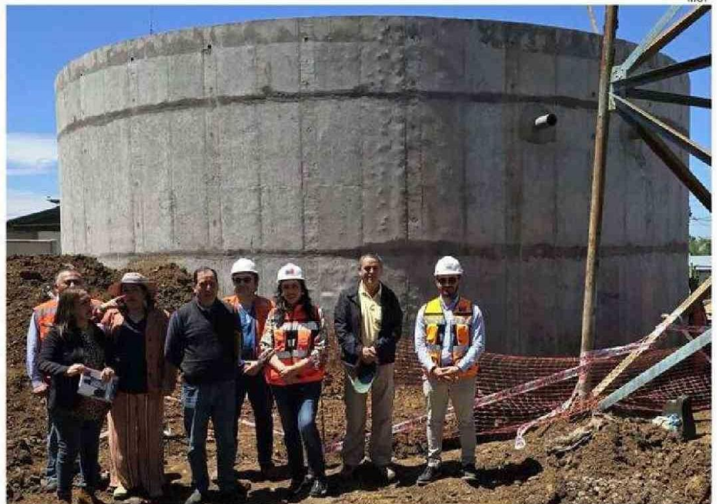
ESTE PROYECTO CONSIDERA LA RECONEXIÓN DE 129 ARRANQUES Y LA INSTALACIÓN DE 4 NUEVOS.
