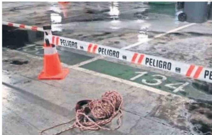
EL ESTACIONAMIENTO DEL HRA TAMBIÉN HA SUFRIDO CON LAS FILTRACIONES DE AGUA.
