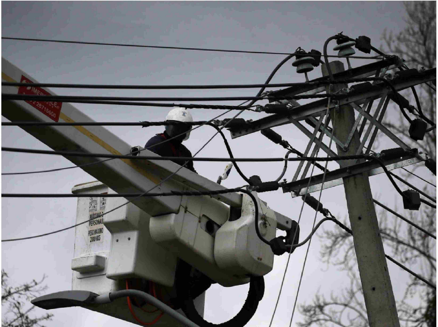
► El gerente general de Enel Distribución, Víctor Tavera, aseguró que el compromiso de la empresa era lograr este martes la restitución del servicio en 60 mil hogares.
