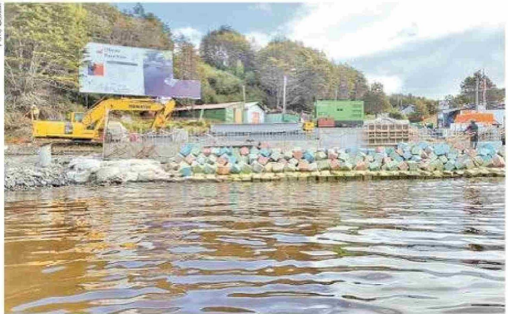
La obra de construcción de la rampa de Puerto Toro presenta un 87% de avance. Se pretende inaugurar en noviembre.
