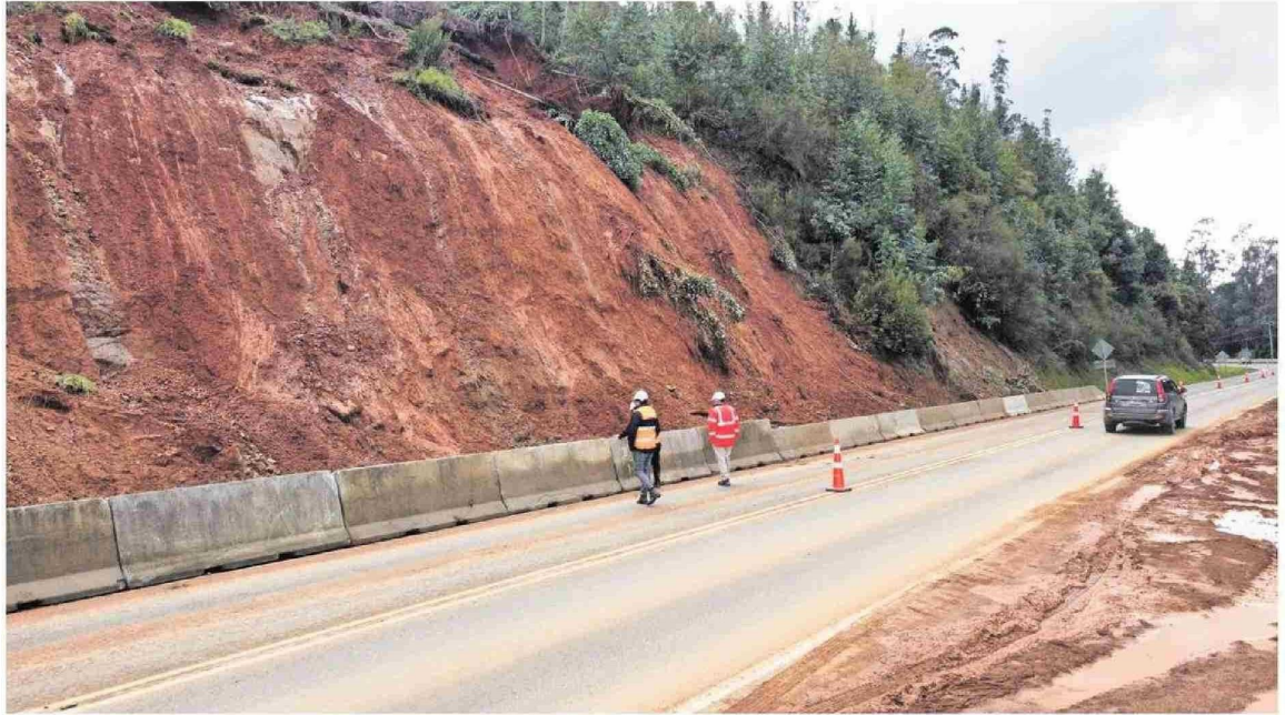
La ubicación de la ruta de la Madera, de características que la llevan a encajonarse entre cerros y el río Biobío, la hace vulnerable ante las fuertes lluvias.
