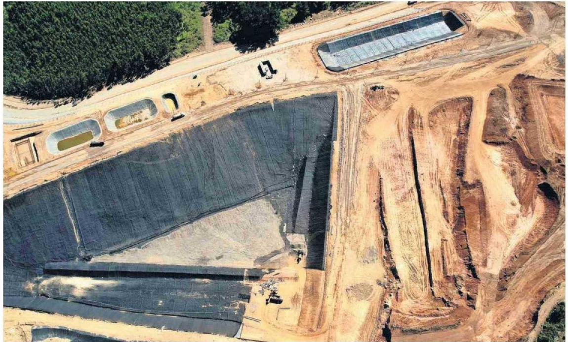
La celda nueva de Cemarc tiene mucha capacidad y está hecha con toda la tecnología disponible, cuenta con doble impermeabilización para más seguridad.
