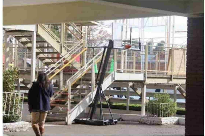
Colegio aseguró que estructura que cedió había sido revisada hace solo algunos meses.
