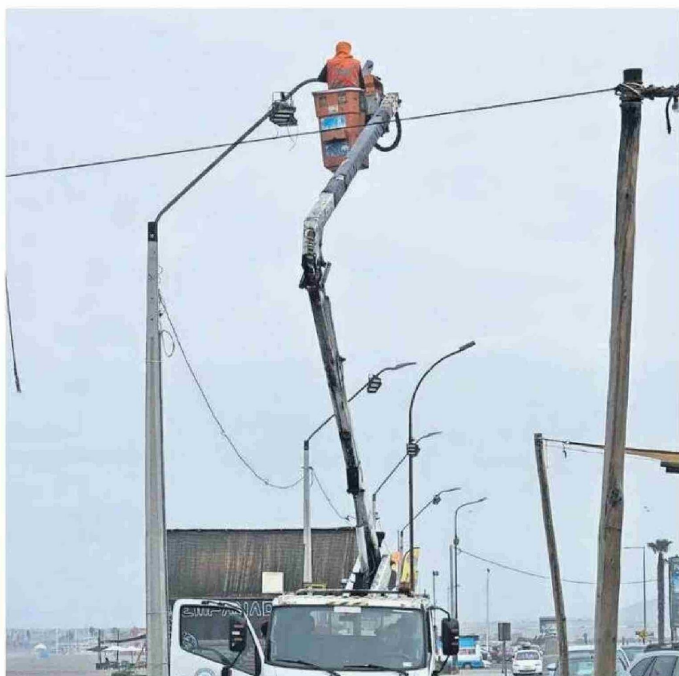
SE REALIZARON LAS REVISIONES CORRESPONDIENTES EN EL TENDIDO DEL SECTOR.
