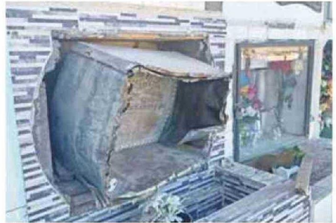
AÚN NO SE HA DETERMINADO LA CANTIDAD DE NICHOS AFECTADOS.
