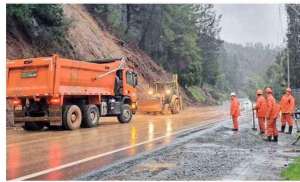
Trabajo en conjunto con la Dirección de Vialidad para habilitar la ruta CH-156 de La Madera.
