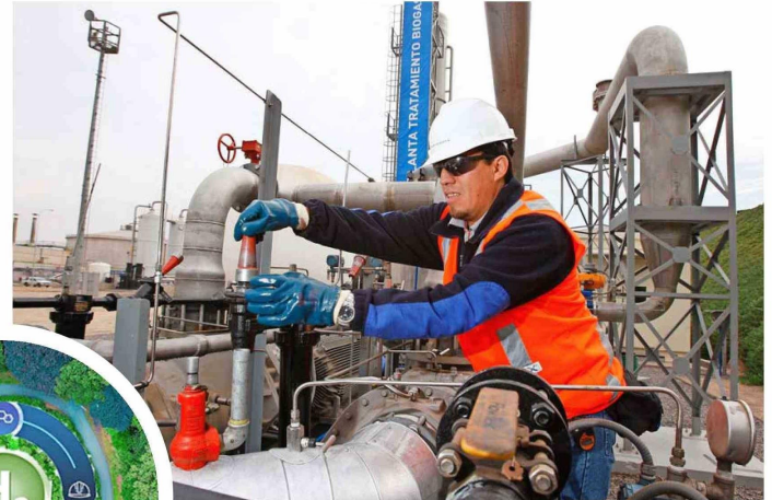
El biogas también es otra fuente energética no contaminante, especialmente en procesos productivos de gran envergadura.
