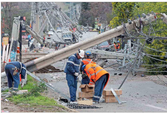
En Peñalolén, Enel ha trabajado en retirar los postes caídos. En esa comuna, anoche había 2.584 clientes sin luz.
