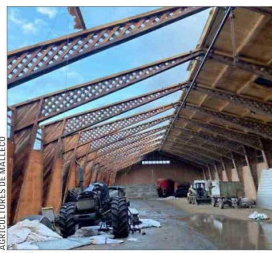
DAÑOS.— Las caídas de árboles y ráfagas de viento provocaron voladuras de techos y daños sobre infraestructura de predios agrícolas.
