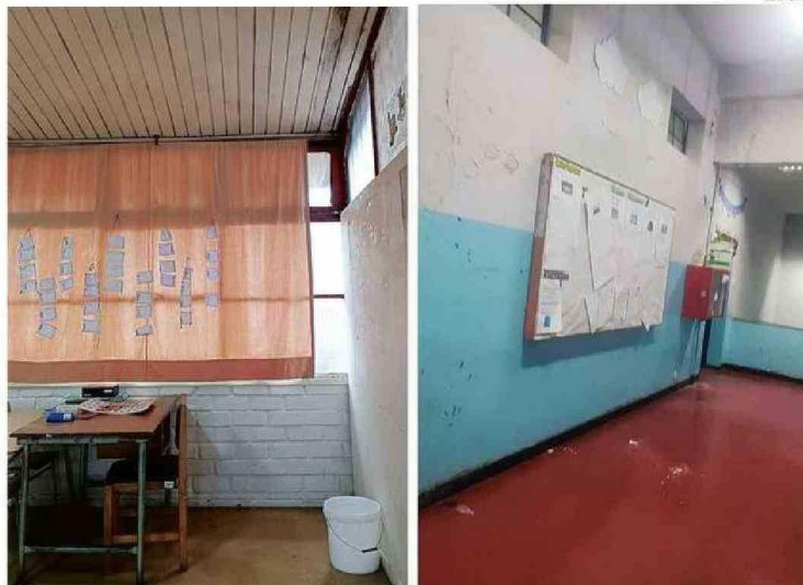
SALAS DE CLASES INUNDADAS FUERON ALGUNOS DE LOS PROBLEMAS DENUNCIADOS POR LOS TRABAJADORES.
