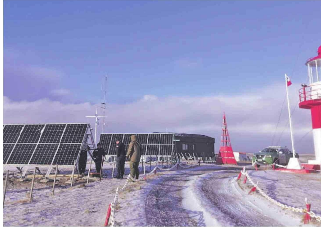
Los paneles solares que Argentina tuvo que desmontar en Tierra del Fuego / CANCELLERIA
