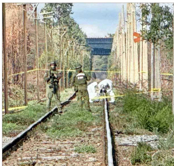
DAÑO. — Pasadas las dos de la madrugada de ayer, una patrulla de avanzada dio aviso a Carabineros la detección de un riel saboteado.
