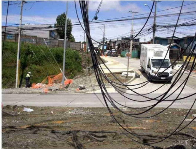
ALO LARGO DE TODO EL TRAMO DE LA INTERVENCIÓN, SE CONTABILIZAN AL MENOS 60 POSTES NO RETIRADOS.
