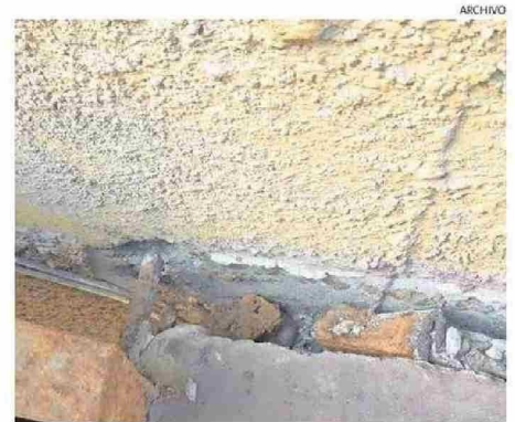
HAY DAÑOS ESTRUCTURALES EN EDIFICIOS, ESCALERAS Y VIVIENDAS.
