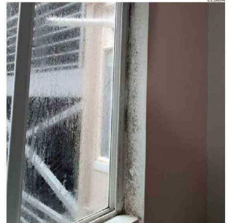
LA HUMEDAD SE CONDENZA EN LAS VENTANAS, PRECISÓ ALBORNOZ.
