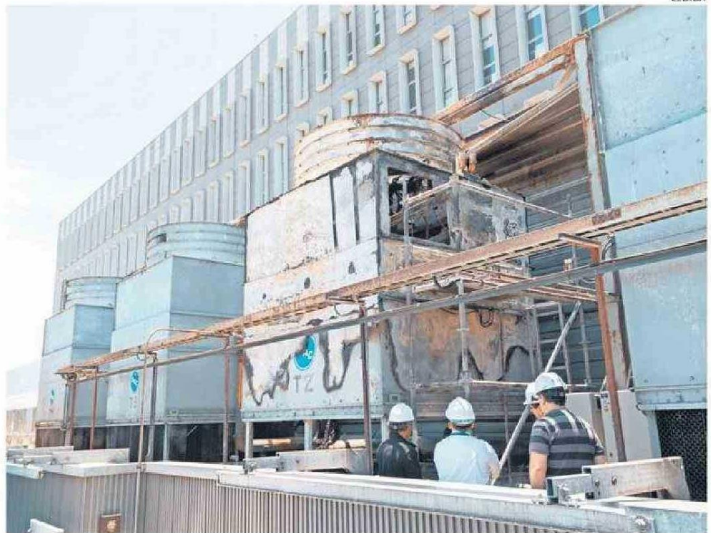
SIGUE LA INVESTIGACIÓN SOBRE EL ORIGEN DEL INCENDIO QUE AFECTÓ AL HOSPITAL REGIONAL
