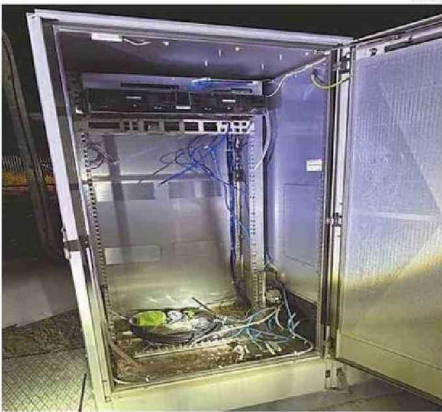
FUERON SUSTRÁIDAS DE ANTENAS DE TELÉFONO.
