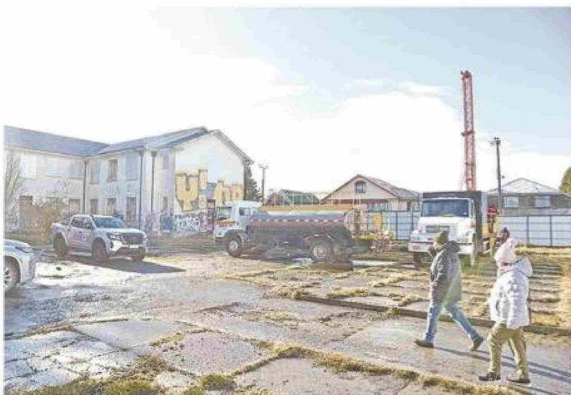
Equipos de la dirección de Vialidad trabajan en labores de estudio de suelo en los patios del viejo hospital.
