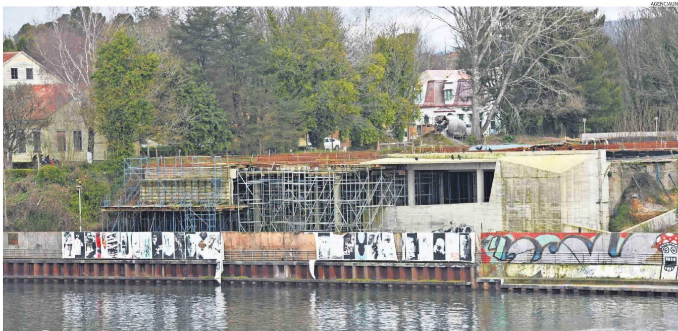
EN 2019 COMENZARON LAS OBRAS PARA LA RESTAURACIÓN Y AMPLIACIÓN DEL MUSEO DE ARTE CONTEMPORÁNEO DE LA UNIVERSIDAD AUSTRAL DE CHILE, EN LA CAPITAL DE LOS RÍOS.
