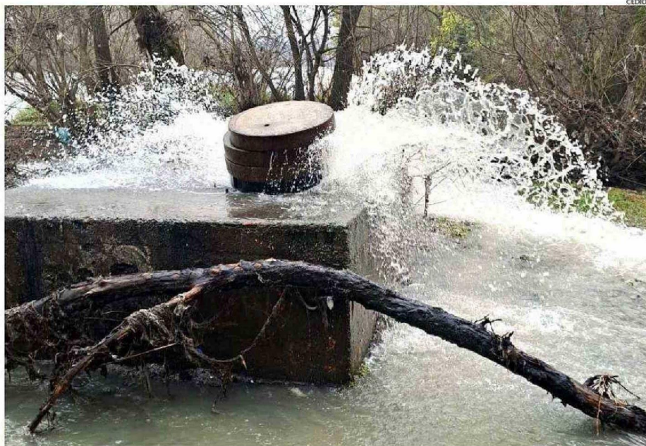
UNA IMPRESIONANTE EXPLOSIÓN DE AGUAS SERVIDAS SE VIO SALIR DESDE LA CÁMARA, TANTO EL 1 COMO EL 10 DE AGOSTO.
