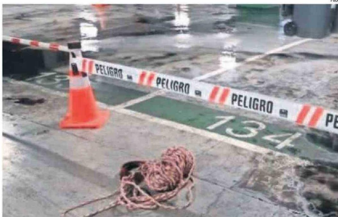
EL ESTACIONAMIENTO DEL HRA TAMBIÉN HA SUFRIDO CON LAS FILTRACIONES DE AGUA.
