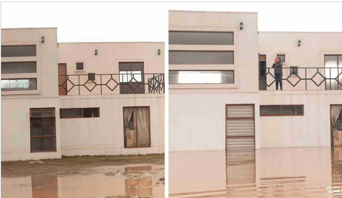
Una muestra de la crecida del agua que afectó la mayoría de las casas en las 32 parcelas del sector Santa Elena.
