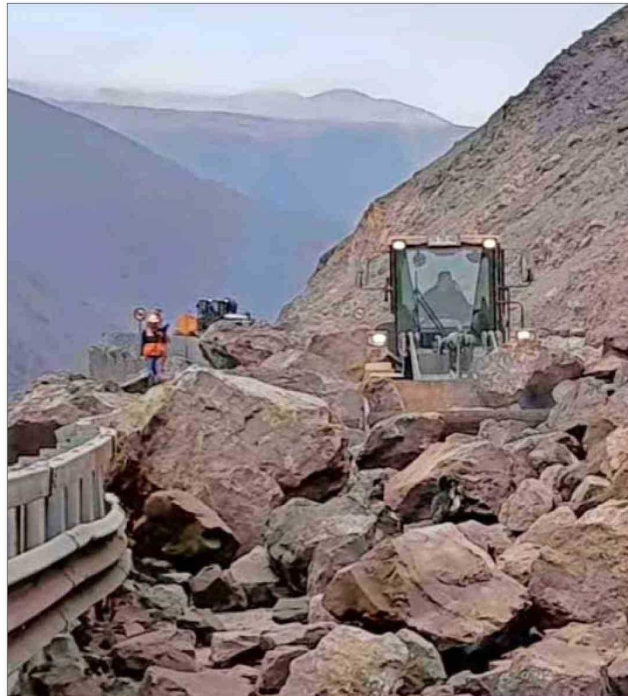
MAQUINARIA. — Vialidad estimó un plazo de un año para la reparación. El pueblo de Cuya ha colapsado por miles de personas y vehículos varados.
