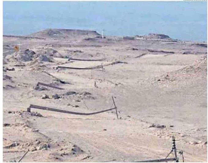
SE ESTIMA QUE LA REPOSICIÓN DE POSTES Y DE LA LÍNEA ELÉCTRICA SE PRODUZCA LA PRÓXIMA SEMANA.
