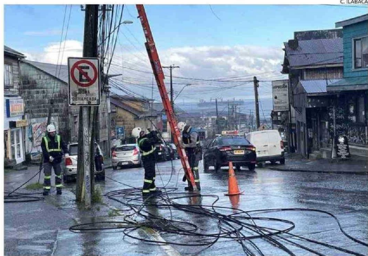
BRIGADAS DE SAESA SE ENCUENTRAN INVESTIGANDO LA SITUACIÓN QUE AFECTA A LA ZONA CÉNTRICA.
