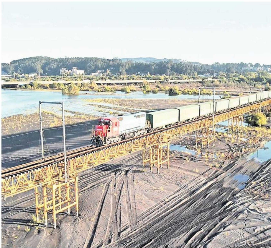
Todos los días cruzaron trenes con distintos niveles de carga para corroborar el funcionamiento del viaducto.
