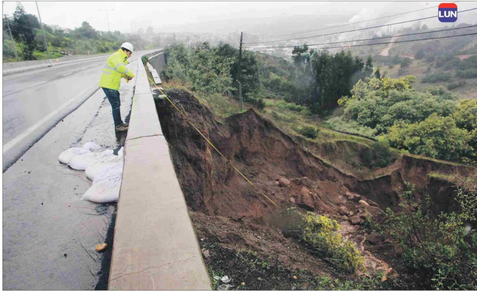
Para enfrentar la emergencia, el MOP desvió las aguas del colector lejos del socavón.
