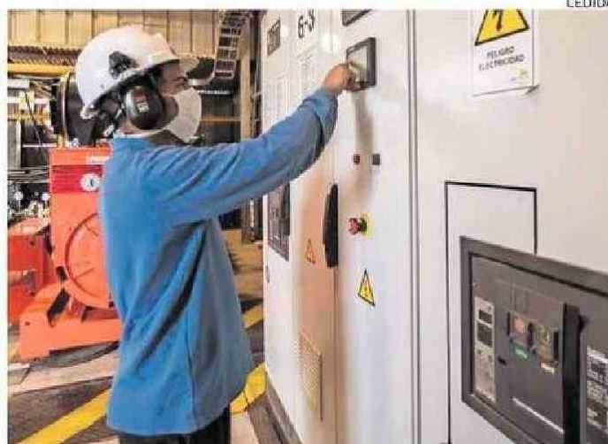
LA COMUNA NO ESTÁ CONECTADA AL SISTEMA ELÉCTRICO NACIONAL (SEN).
