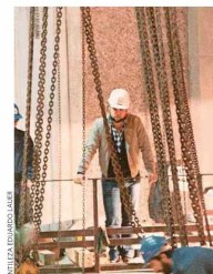
Lauer se define como “faenero”, un ingeniero de terreno. “Para mí, no hay nada mejor que construir, ver que algo está saliendo de la tierra y después funciona. Eso es increíble”.
