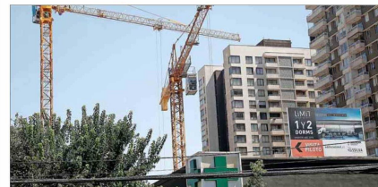
Construcciones de edificios en sectores alrededor de avenida Macul, donde hay varias obras inmobiliarias frenadas.
