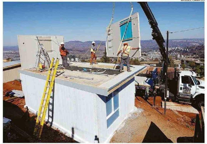
PRIMERAS 4 VIVIENDAS COMENZARON A CONSTRUIRSE EN MAYO. DESDE ENTONCES, NO HAY GRANDES AVANCES.
