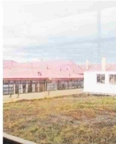
El sector de cursos de prebásica de la Escuela Bernardo O'Higgins es el que presenta mayores falencias por el ingreso de agua por los pisos cuando llueve mucho.
