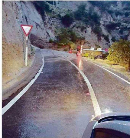
CORTE DE CAMINO EN COLLIGUAY DEBIDO A LOS DERRUMBES.
